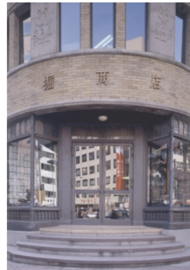
正面の石段は地盤沈下のため、あとから作られた
