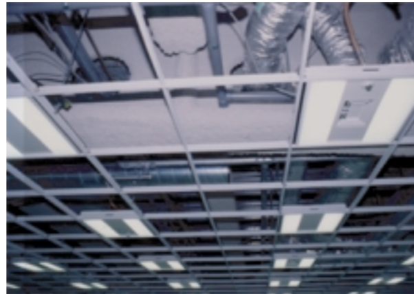
60cm×60cmのグリッドで構成されているため、自由に部屋をつくるができる。さらに照明、空調吹き出し口、火災報知器、スプリンクラーをすべて一つのグリッドに一体化しているため、レイアウト変更にも容易に対応可能だ
