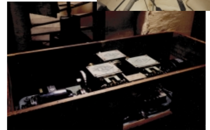
地下1階に設置された現在の親時計。以前は5階の振り子時計が親時計として使われていたが、地震や温度変化によっておこる時間のズレを考慮して、水晶時計に交換された。市政会館内部のあちこちに置かれている子時計の中にも、この親時計と連動しているものがある
