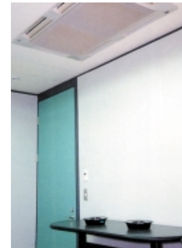
各フロアに1カ所ずつ設置している。室内の煙は、直接ビルの外部へ排出する空調システムを採用。職場の衛生環境を徹底的に追求したクリーンエア設計になっている
